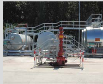
Erdöl und Erdgas werden noch für lange Zeit als Energieträger benötigt
